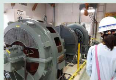
九州電力水力発電所 内部
